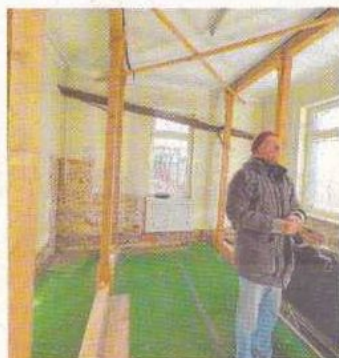
Die Balken müssen weg.
